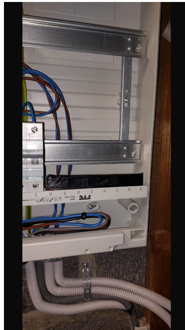
(Elektrisch bord - binnenkant)
