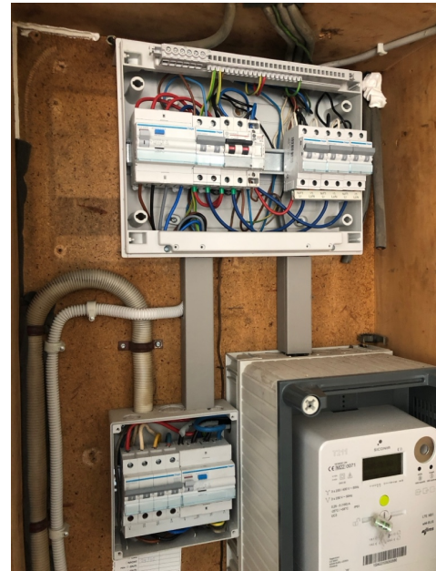
(Elektrisch bord - binnenkant)
